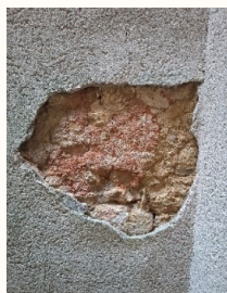
Gonflement lié à un enduit extérieur étanche
