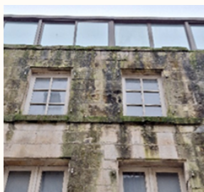
Moisissures en façade liées à une verrière
